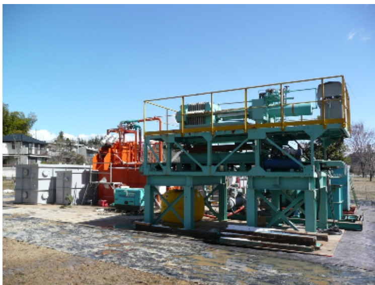
写真-2 浄化プラント
