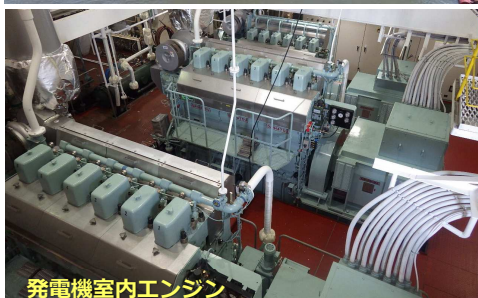
発電機室内エンジン
