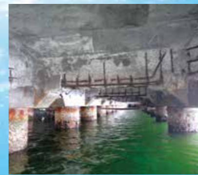
補修前 棧橋下面コンクリート劣化
