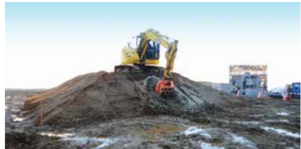
現地実証実験状況
