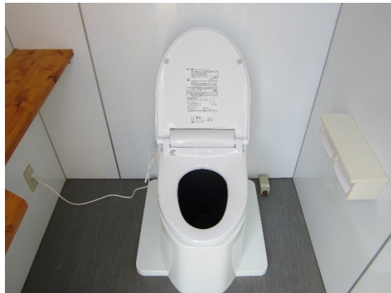
快適トイレ内部（暖房便座付き）
