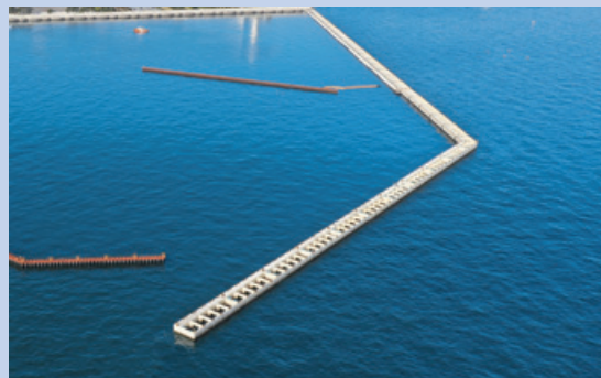
新本牧ふ頭建設工事（その29・外周護岸B-2基礎及び本体工）
