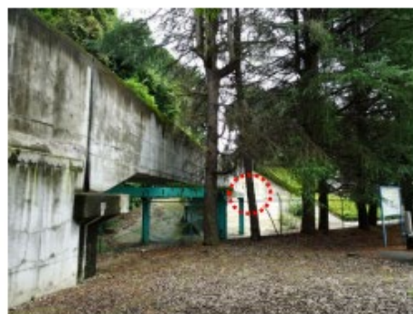
写真 1.6 監視位置 P1 (東側境界付近)
